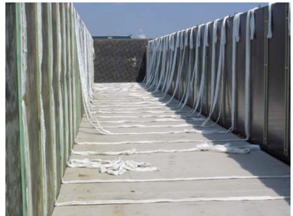
Foto 4: Bekisting met afmeting 30m (l) x 3m (b) x 2m (h) waarin het zand cementmengsel zal worden gepompt. De hijsbanden liggen klaar alvorens het PVC geomembraan en het voorgeconfectioneerde geotextiel wordt geplaatst.
